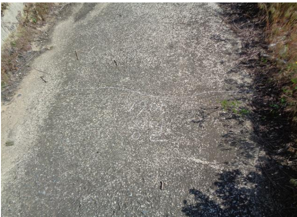
위 치 STA.2+310 1소단배수로 내 용 균열
