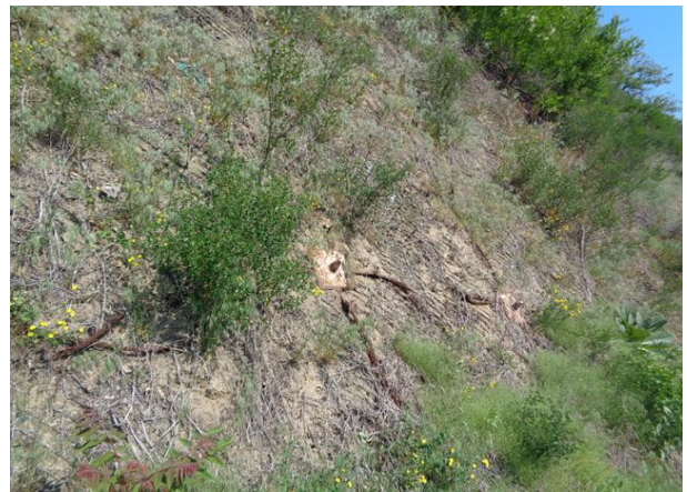
위 치 STA.2+350~420 2단 내 용 와이어로프 녹발생 및 능형망 노출
